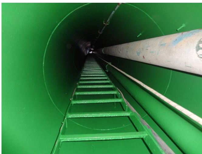
A HG 100/30,5 típusú acél szerkezetű magas víztároló tartó csőszárának belső része a rekonstrukciót követően
